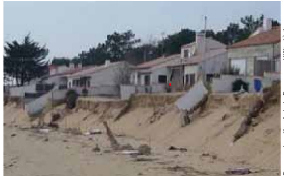
Recul du trait de côte à la Tranche sur Mer (Vendée) ayant causé l'endommagement de maisons situées en première ligne.
