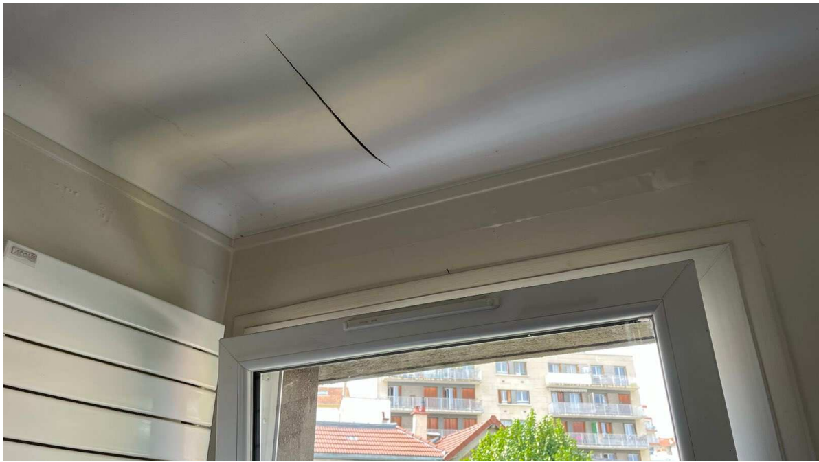
FIGURE 52 – File : allpdf/IMG_1785.pdf, SAM, mur au-dessus de la fenêtre gauche, 1 août
