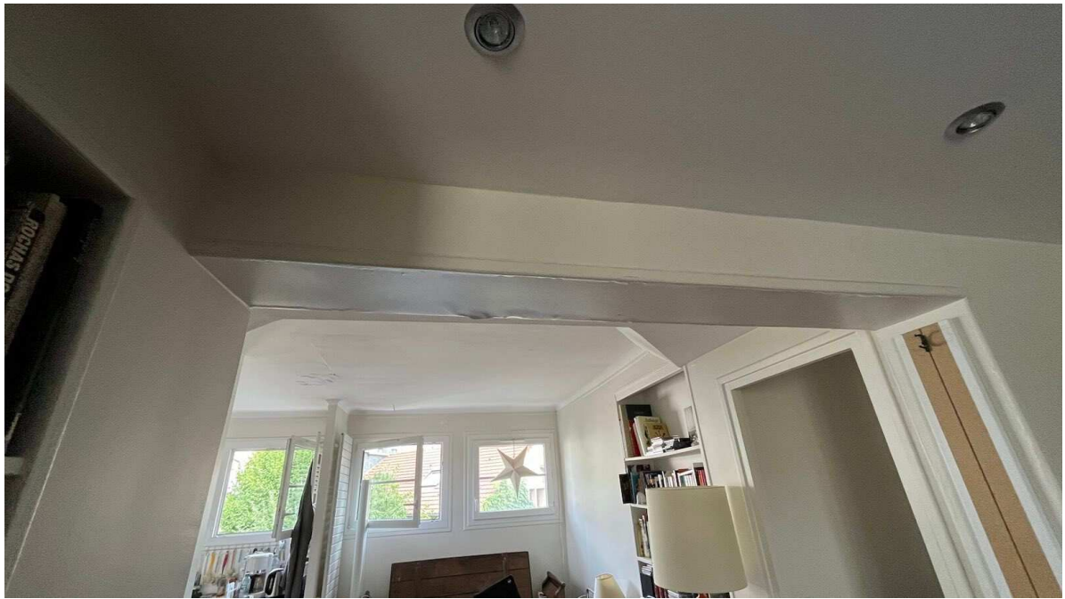
FIGURE 3 – File : allpdf/IMG_1637.pdf, plafond SAM et faux plafond depuis séjour, 1 aout
