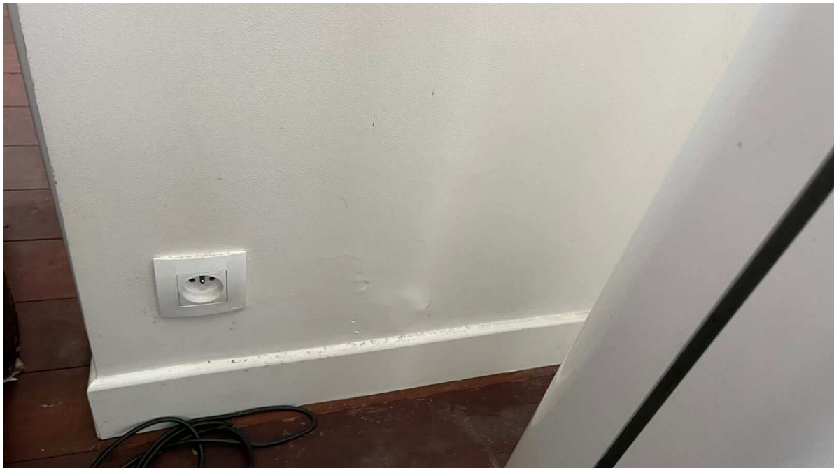
FIGURE 50 – File : allpdf/IMG_1782.pdf, SAM, mur côté cuisine, au-dessous du radiateur, 1 août
