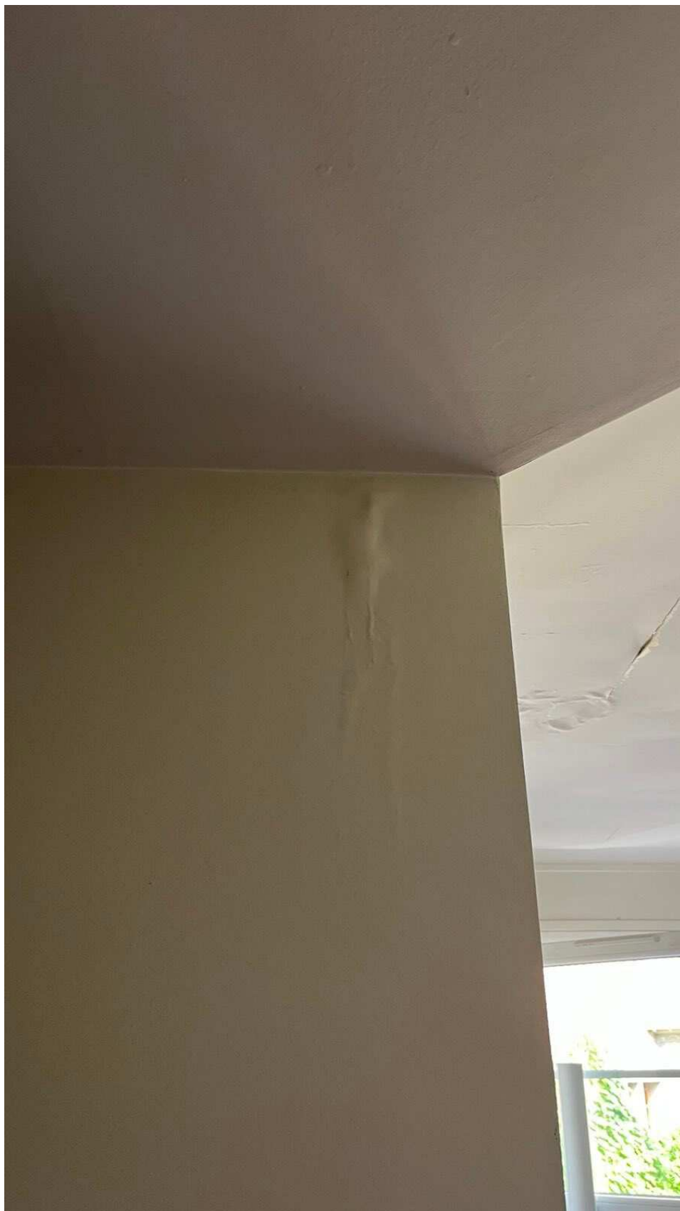
FIGURE 13 – File : allpdf/IMG_1647.pdf, entrée, mur côté cuisine, 1 aout
