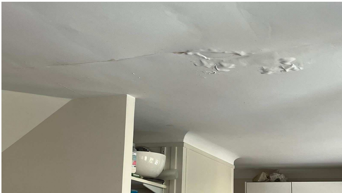
FIGURE 29 – File : allpdf/IMG_1757.pdf , plafond SAM-cuisine, détail gros dégats, 1 août
